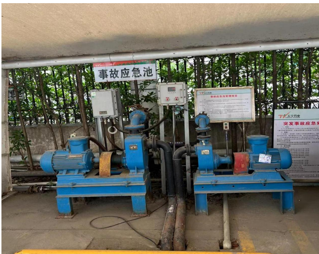
初期雨水收集池、事故应急池
