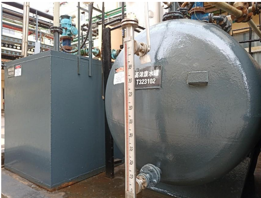
高浓废水分质、分类收集罐
