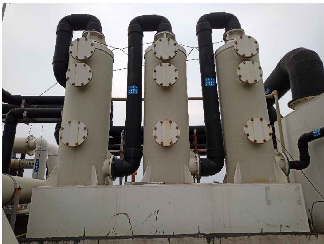
车间外废气喷淋塔
