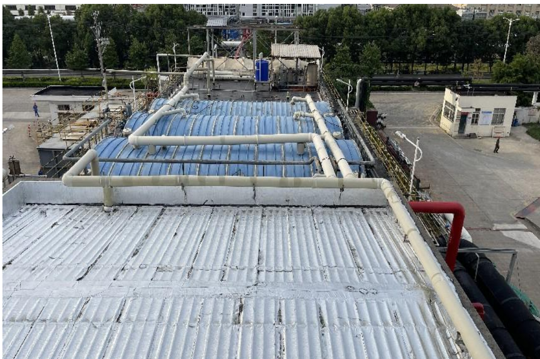
废水站废气收集管路
