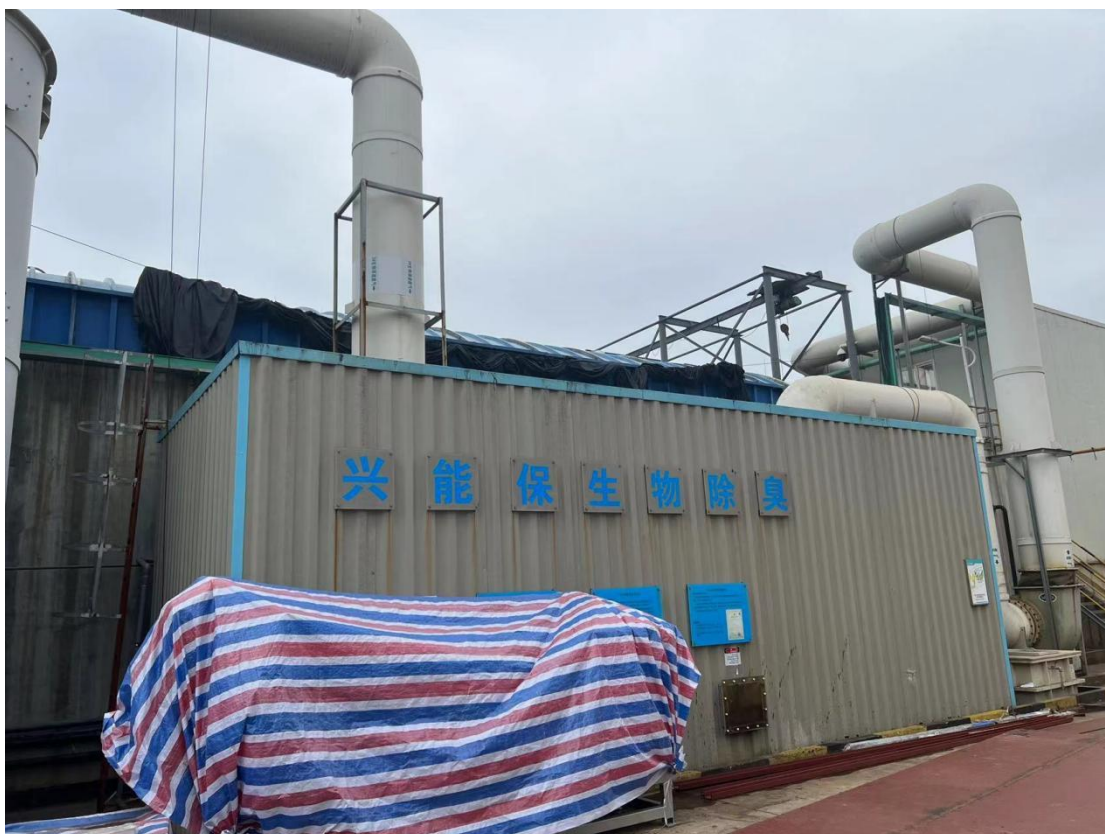
氧化喷淋塔+生物滴滤除臭系统
