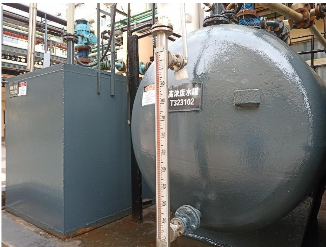
高浓废水分质、分类收集罐
