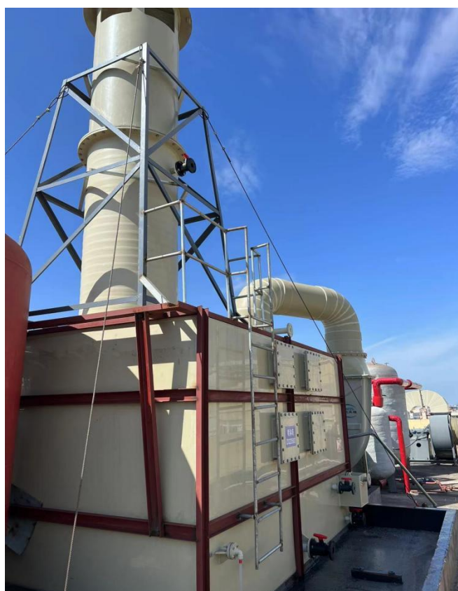
32、33 系列车间隔间废气排气筒 (DA003、DA004)
