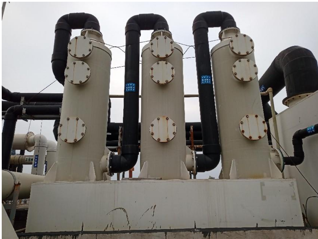
车间外废气喷淋塔
