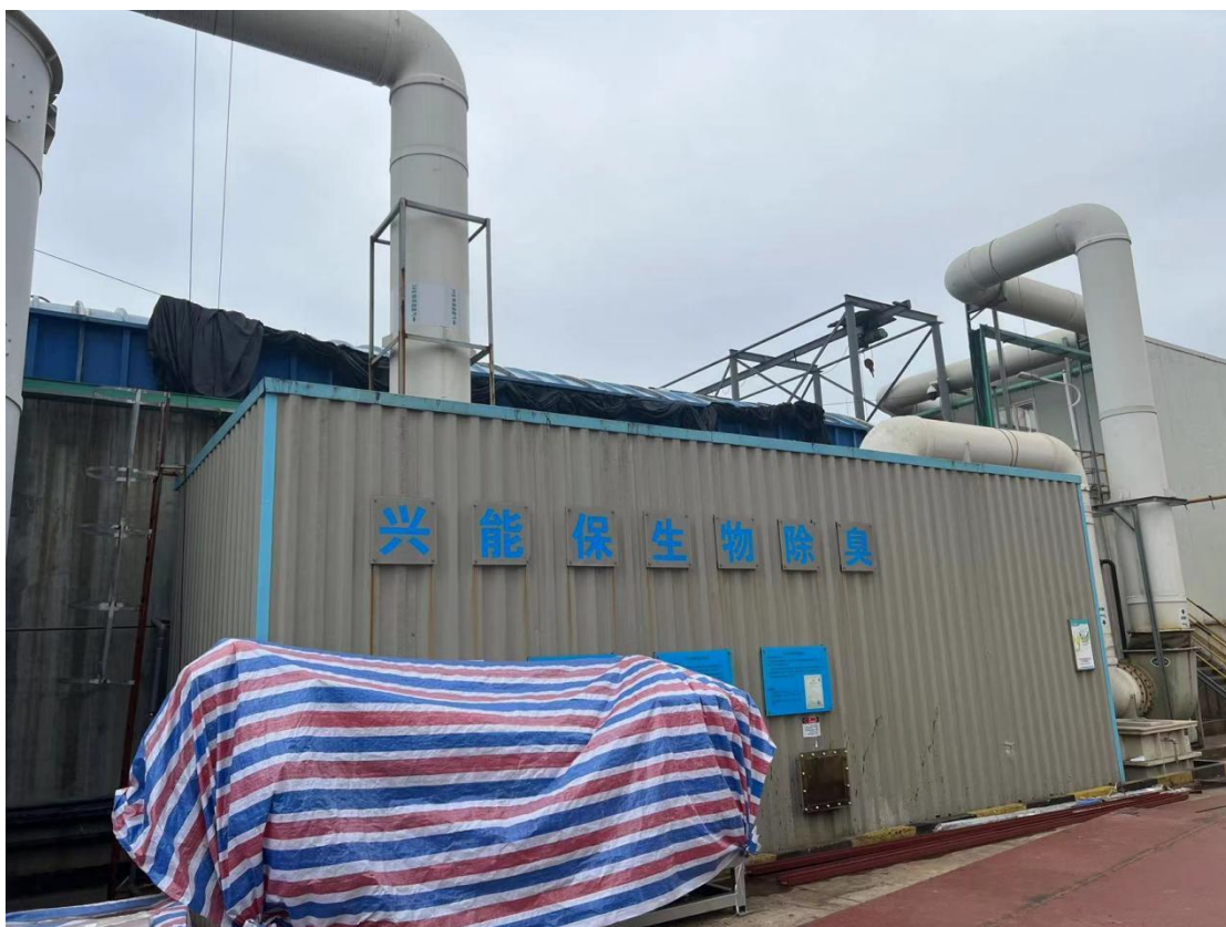
氧化喷淋塔+生物滴滤除臭系统
