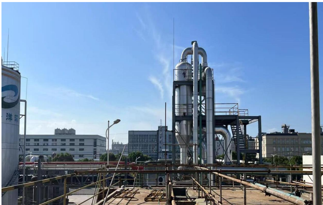
废水预处理设施 (MVR)
