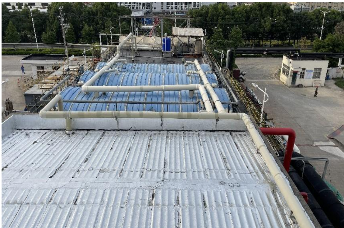
废水站废气收集管路
