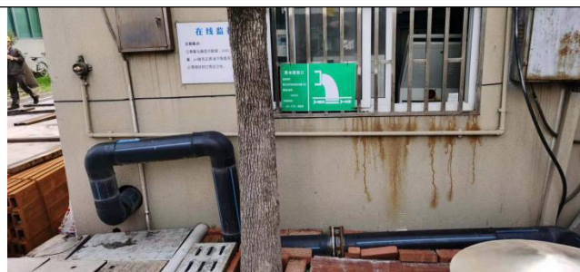
废水总排放口
