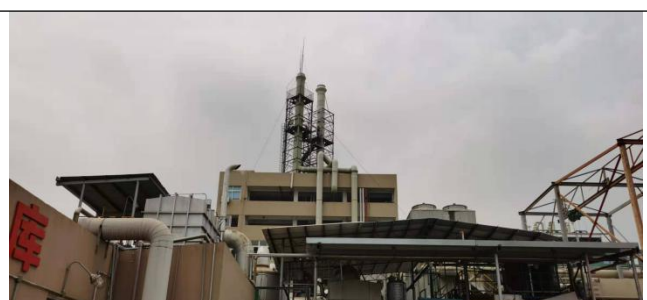
RTO、生物滴滤废气排放口
