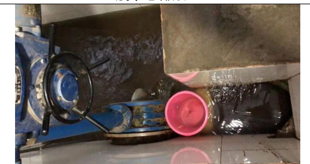
南厂区雨水排放口
