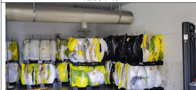
危废堆场废气收集
