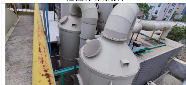
生物滴滤废气处理设施
