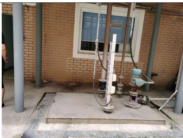
研发车间废水收集池
