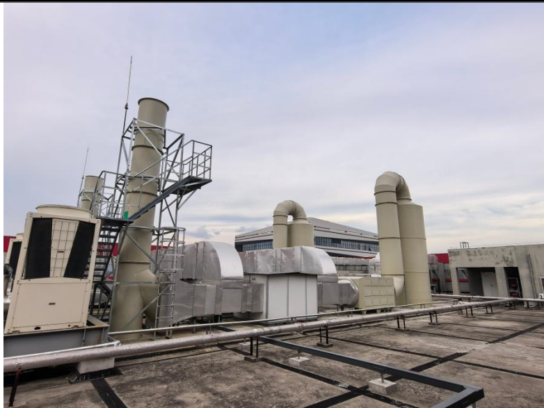
图 3-1 废气处理设施及排气筒
